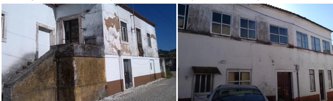
Figura 15 - Edifícios ocupados como 1ª habitação mas em condições insalubres
