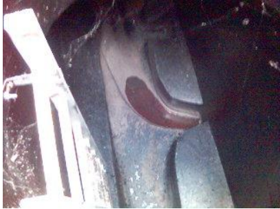
Vista da câmara de válvula do tipo vórtice: câmara seca e câmara húmida.
