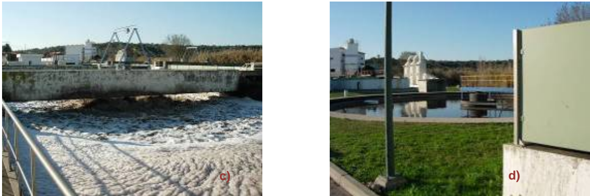
Figura 4.11 – Fotografias da ETAR de Alcanena: a) decantadores primários b) e c) tanques de lamas activadas; d) decantadores secundários.
